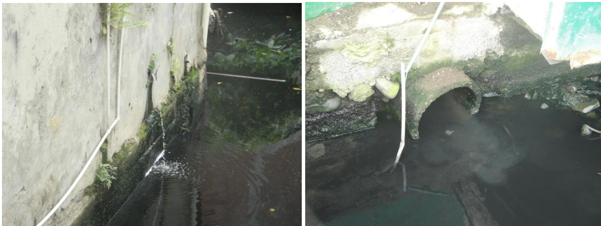
Figura 4.1.3. Vertimientos domésticos directos: disposición inadecuada de residuos líquidos, nótese los diferentes tubos que salen de las viviendas y descargan directamente al cuerpo de agua.
